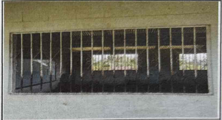
Se observa el deterioro del balcón frontal del aula de Segundo Grado.
