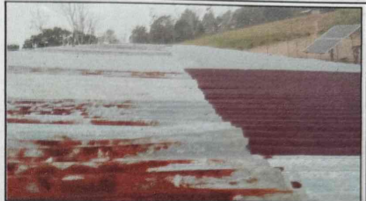
Se observa el deterioro de las láminas. Se cambiara por completo las laminas por mala instalación, la cual en tiempo de invierno provoca filtración de agua.
