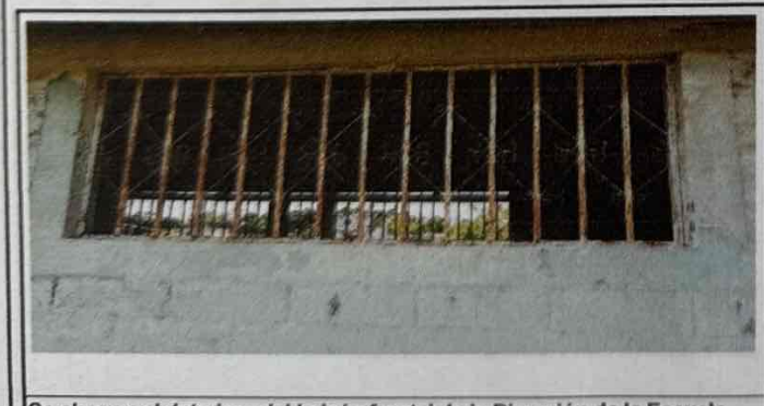
Se observa el deterioro del balcón frontal de la Dirección de la Escuela.
