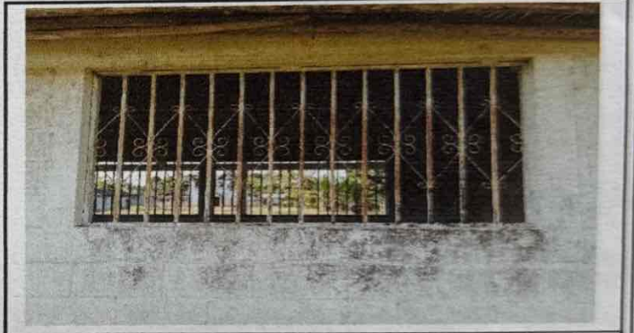
Se observa el deterioro del balcón lateral de la Dirección de la Escuela.
