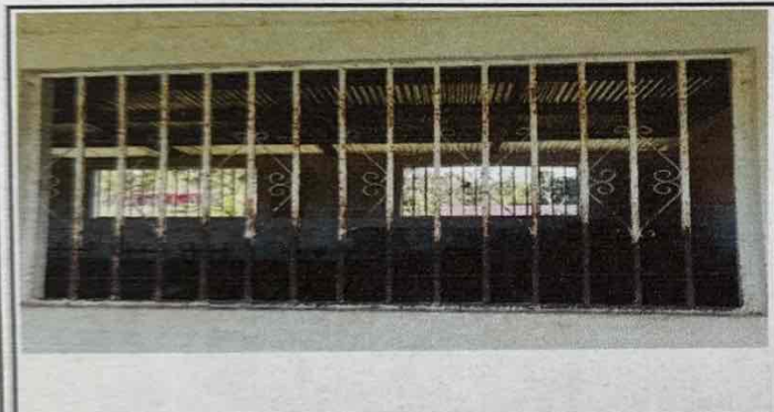
Se observa el deterioro del balcón frontal del aula de Tercer Grado
