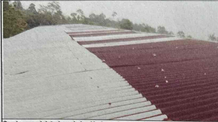
Se observa el deterioro de las láminas. Se cambiara por completo las laminas por mala instalación, la cual en tiempo de invierno provoca filtración de agua.
