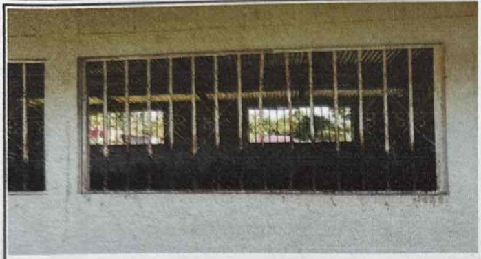
Se observa el deterioro del balcón frontal del aula de Primer Grado
